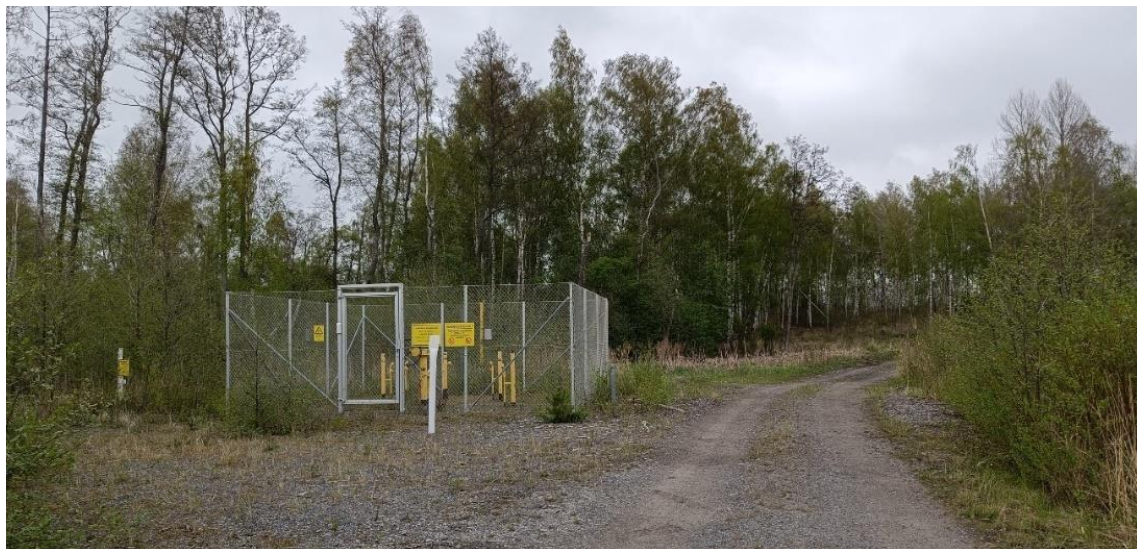
Kuva 22. Kaava-alueella sijaitseva maakaasun venttiiliasema.
